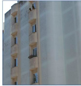
Ejemplo de puente térmico sobre fachada
